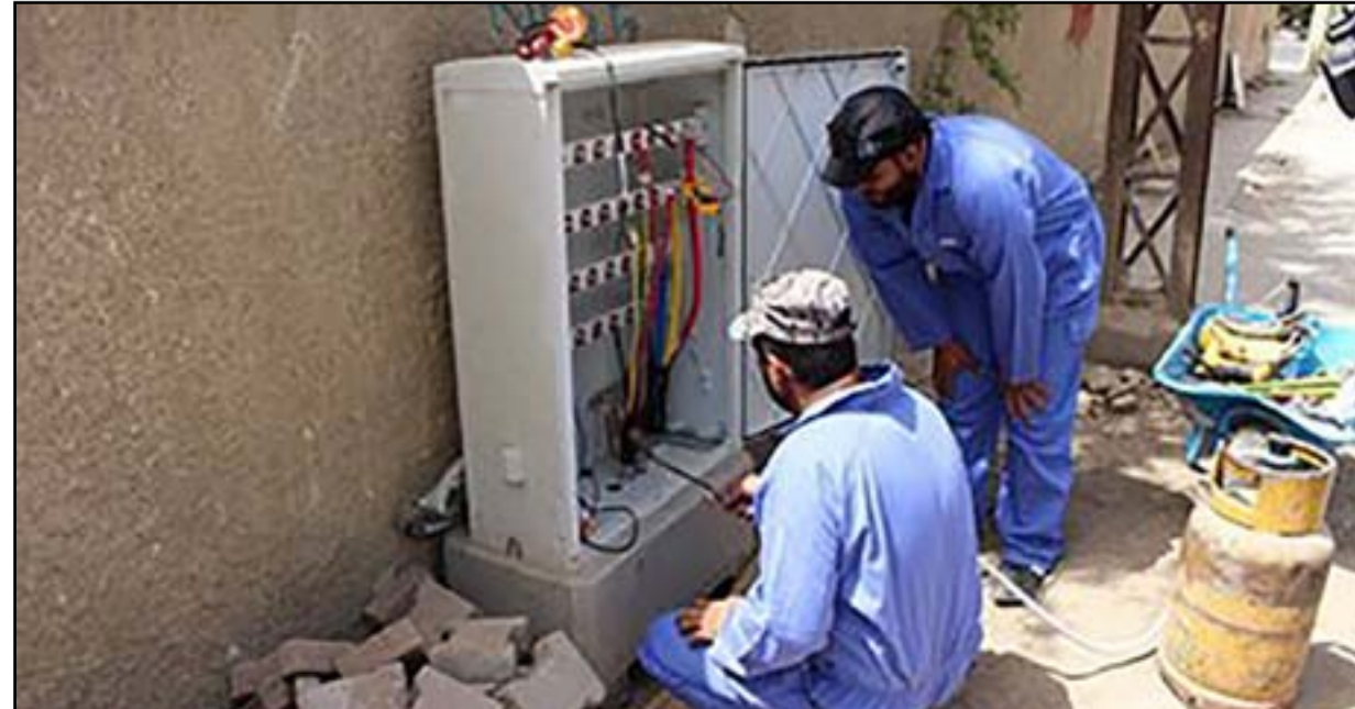
مشروع الشبكات الأرضية أحد عوامل إنها أزمة الكهرباء
